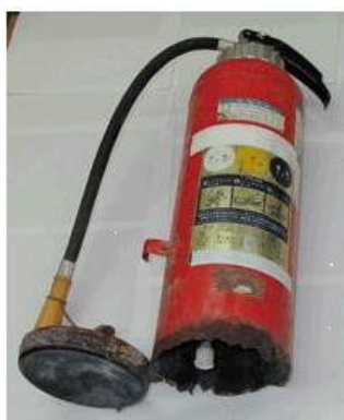
腐食により底板の外れたもの
