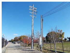
写真 5-35 引込柱、分電盤
