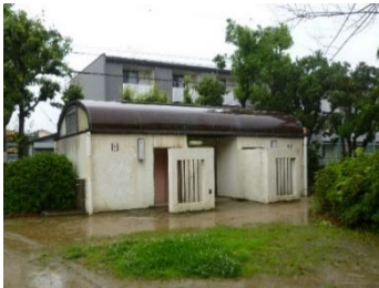
老朽化したトイレ（三十合池公園）
