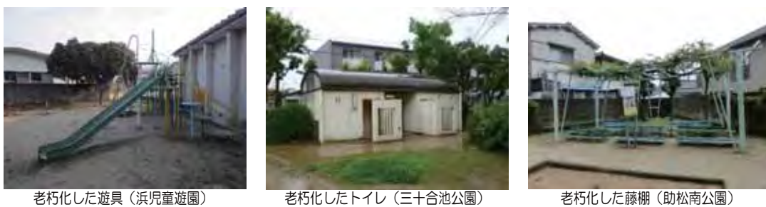
図15 老朽化した公園施設の状況
