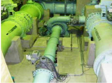
【図表 37 水道管に導入した小水力発電】
