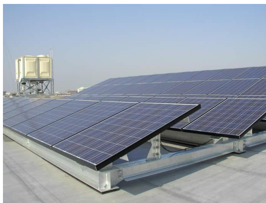
【図表 34 穴師小学校の太陽光パネル】
